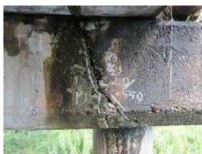
▲橋脚のひびわれ
